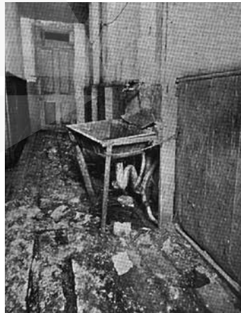
Fotografía 1.7. Vestíbulo y lavabo públicos. El segundo está sostenido únicamente por cuerdas y endebles soportes de madera. El suelo está cubierto de aguas negras y residuos fecales (1903).
